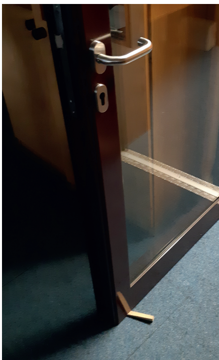
Abb. 1: Unzulässiges Verkeilen einer Brandschutztür
