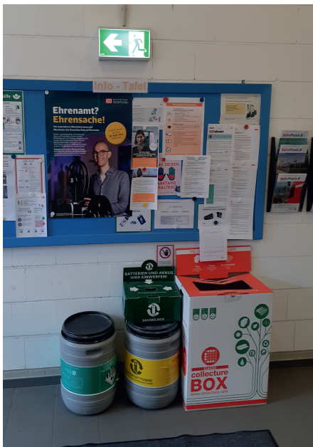
Abb. 5: Unzulässige Brandlasten im Fluchtweg
