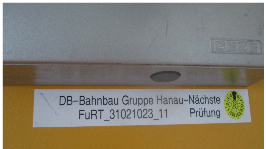
Abb. 4: Prüfsiegel auf einer Brandschutztür
